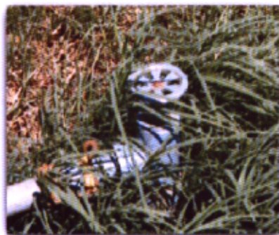
Fig.59. a. Hidrante no protegido
